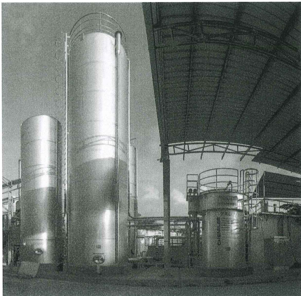
Hệ thống xử lý nước
